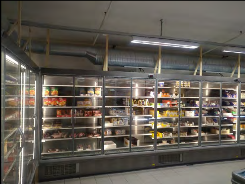
Punktavsug fra Plug-in kjøle- og fryserom på lager
